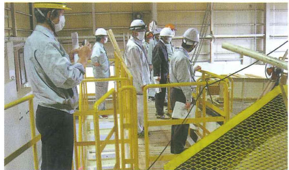
ウッドリサイクルセンターの木質バイオマス燃料加工施設
